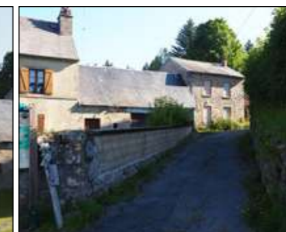
La rénovation en parpaing du muret extérieur dénature l'ensemble patrimonial
