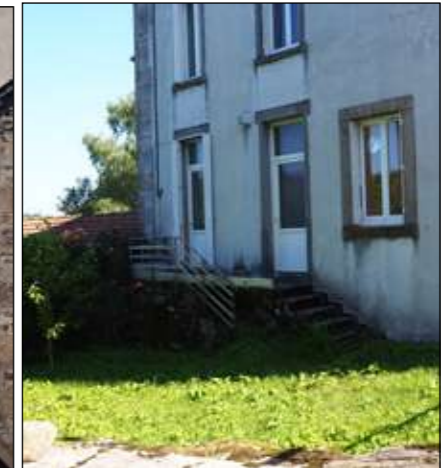
Accès de service au rez-de-chaussée. Qualité médiocre des menuiseries
