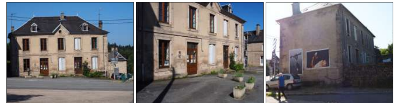
la peinture blanche des volets métalliques contrecarre l'aspect patrimonial / la taille des pots de fleur reste réduite par rapport à l'espace public et au bâtiment / enduit extérieur à restaurer
